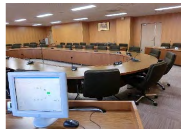
委員会室の音響システム
