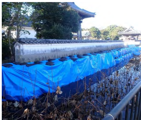
崩壊が懸念されるため大型土のうで保護した本證寺の石垣
