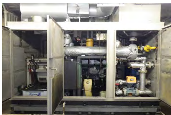
【コージェネ発電設備(内部)】
