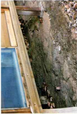
▲ 北側床下に生じた亀裂
