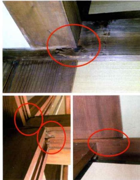
▲ 差鴨居のホゾ入れ部分に生じた剪断
