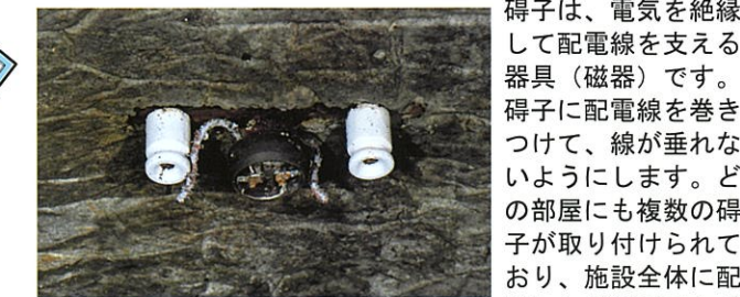
▲ 天井に取り付けられた碍子
