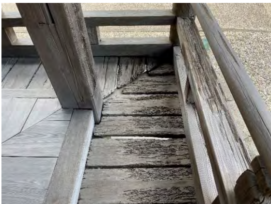
本堂縁側：日光・風雨による風化が進行している
