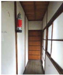
庫裏地区の廊下に 設置された消火器
