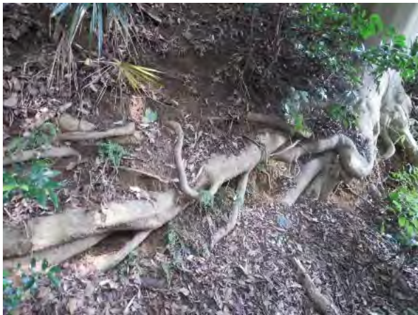
東側外土塁南側斜面 樹木の樹根が土塁斜面を大きく覆う
