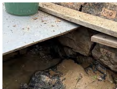
石垣背後からの雨水流出状況
