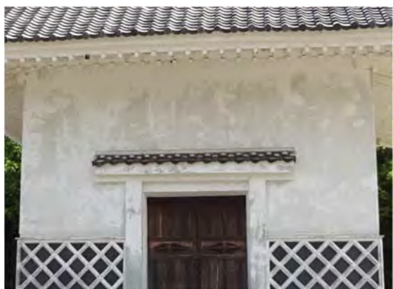
経蔵 漆喰の剥がれが目立つ
