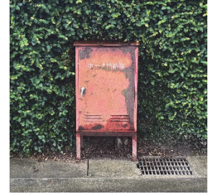
池の南にあるホース格納箱 (近くに屋外消火栓がある)
