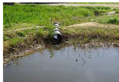
排水管の管底が排水路より低いため、排水路の水位が上がると逆流がみられる
