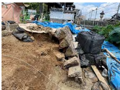
築石背後の土砂流出による空洞化
