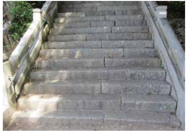
図 56 後円部斜面のはらんだ石段⑫
