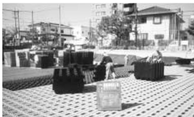
平成15年4月に完成した細田公園(城南町)の地下貯留施設。1,200㎡の雨水をためることができる
