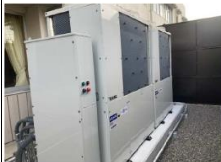
自立発電ユニット(手前)と室外機(奥)
