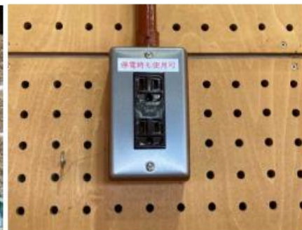
非常用コンセント
