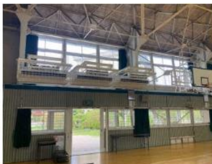
屋内運動場に設置した室内機
