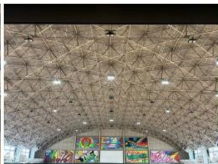
屋内運動場の非常用照明
