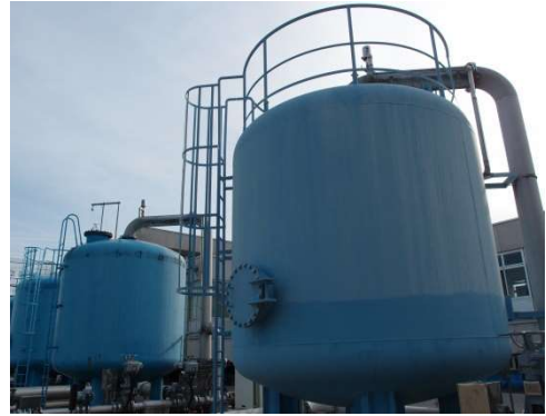
北部浄水場ろ過機
