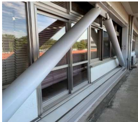
熱損失の大きい掃き出し窓
