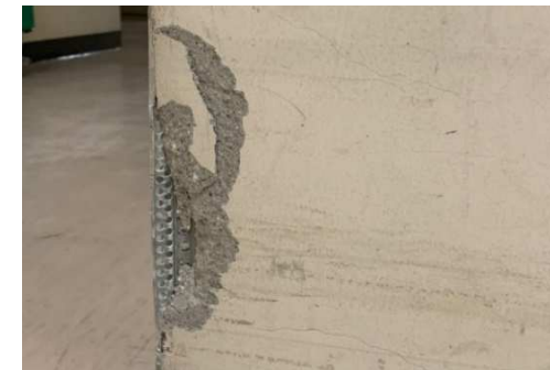
内壁が大きく破損している様子 (北庁舎)
