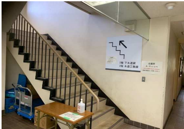
壁側に手すりのない階段 (西庁舎)
