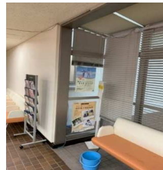
雨漏りしている様子 (本庁舎)
