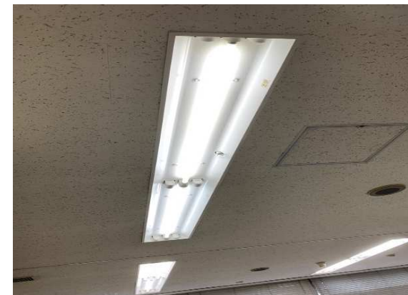
節電のため間引かれた蛍光灯 (LED化未了)
