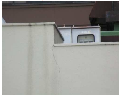
外壁がひび割れている様子 (本庁舎)
