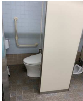
狭いトイレブース (本庁舎)
