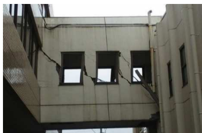
地震により損傷した庁舎
