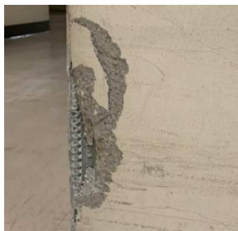
内壁が損傷(北庁舎)
