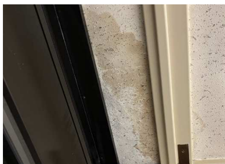
天井の雨漏り痕(北庁舎)
