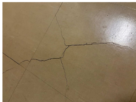
廊下タイルのひび割れ(本庁舎)
