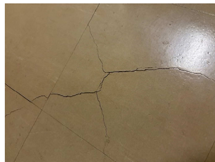
廊下タイルのひび割れ(本庁舎)
