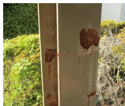
柱の錆(さくら庁舎)
