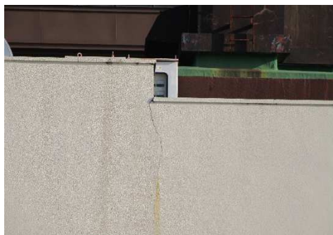
外壁に亀裂(本庁舎)
