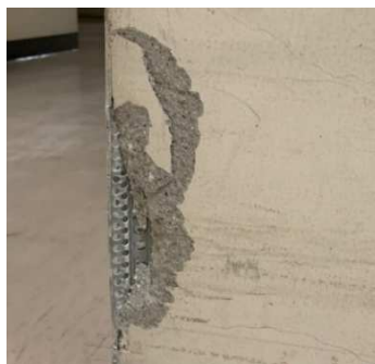
内壁が損傷(北庁舎)
