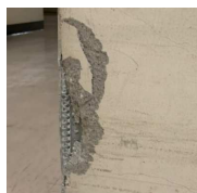
内壁が損傷（北庁舎）
