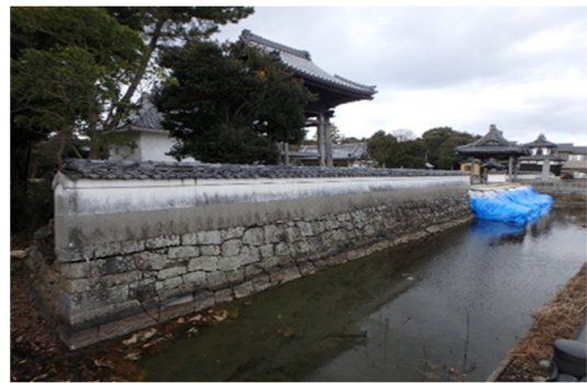
崩壊が懸念される石垣
