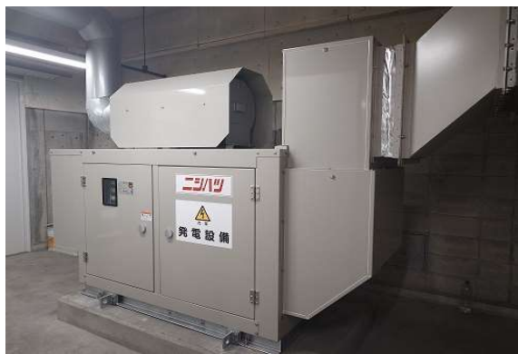
【非常用自家発電設備】
