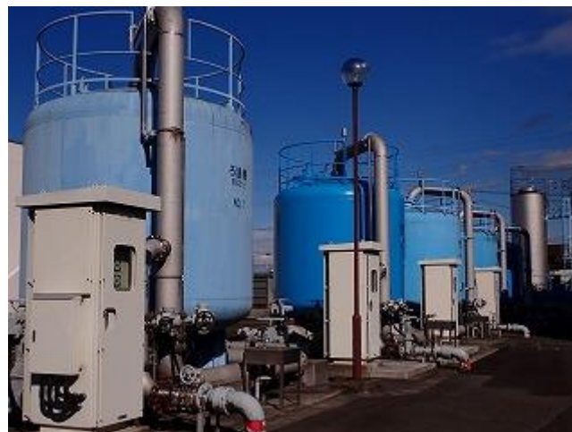
ろ過機（北部浄水場内）
