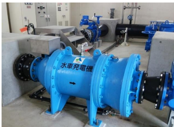
小水力発電（中部配水場内）
