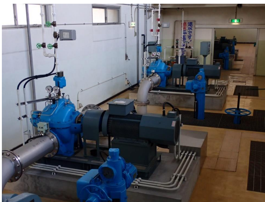
配水ポンプ (北部浄水場内)
