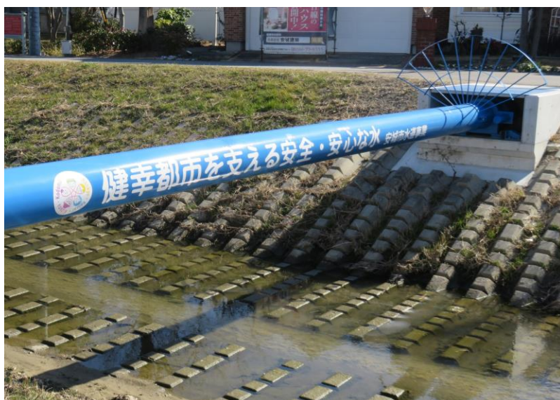
水管橋φ400mm（堀内川）
