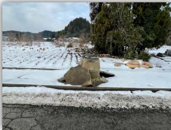
液状化によりマンホールが浮上（能登半島地震）
