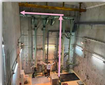
中継ポンプ場内の様子
