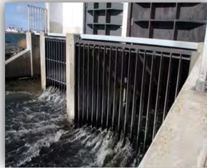
処理された水が放流されている様子
