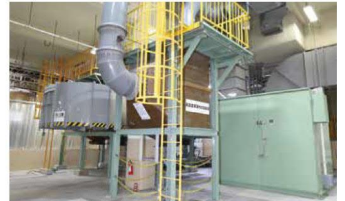
■活性炭吸着塔
