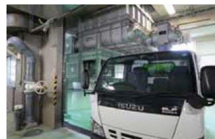
脱水汚泥ホツパ
