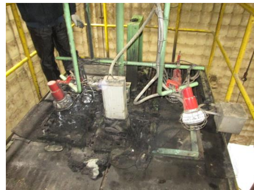
R6.12.24 リサイクル プラザ火災
