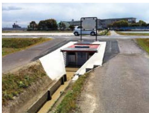
水田貯留調整マス
