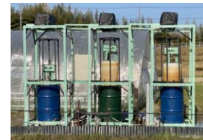
メタンガス 貯留供給装置
