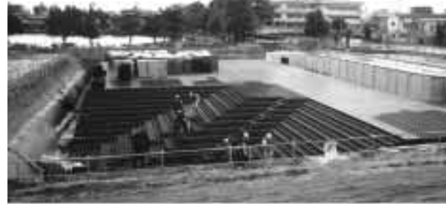
今年4月に完成した大池公園(大東町)の雨水貯留施設。 3000m 3 の雨水をためることができる
