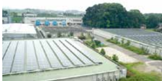
北部浄水場太陽光発電設備
